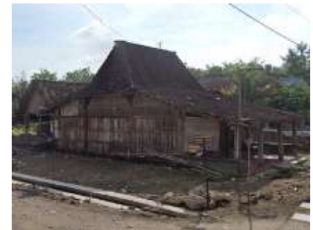
Kondisi Bangunan Kumuh di Batarsari
