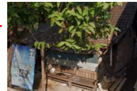
Kondisi Bangunan kumuh di Sayung A
