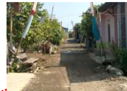
Jaringan jalan yang belum dilengkapi drainase
