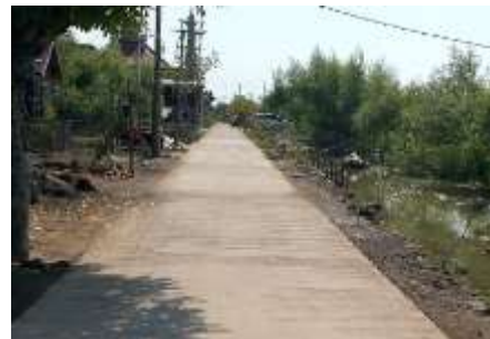
jaringan jalan terbuat dari beton, tanpa jaringan drainase
