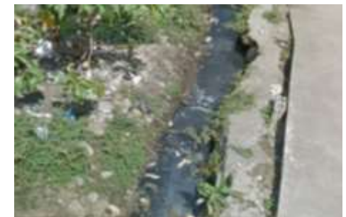
Kondisi saluran drainase di kawasan Brumbung
