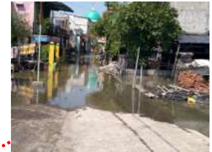
jalan lingkungan terbuat dari paving dan tergenang banjir rob
