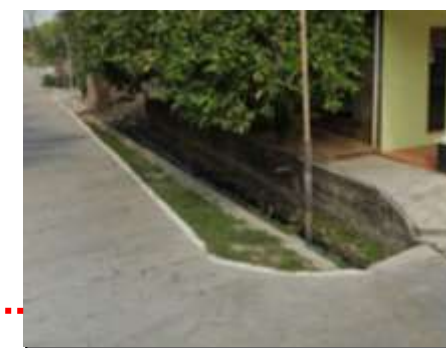
Kondisi Drainase di Tempel-Krajan
