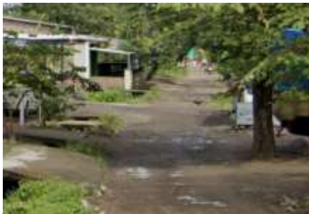
Kondisi Jalan lingkungan berupa jalan tanah
